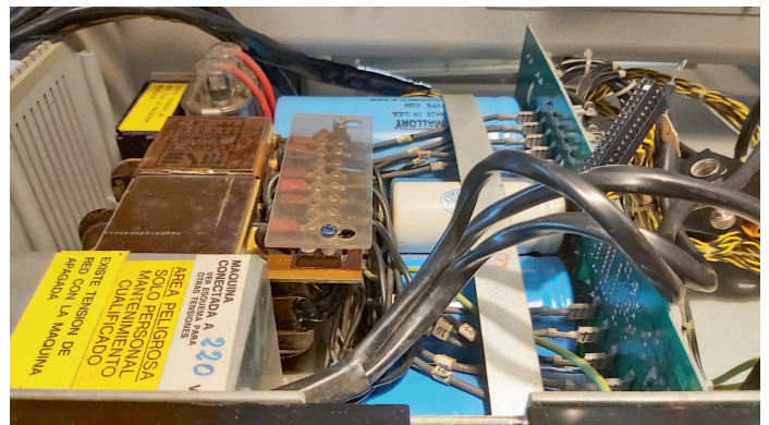
Das Netzteil ist groß und schwer
